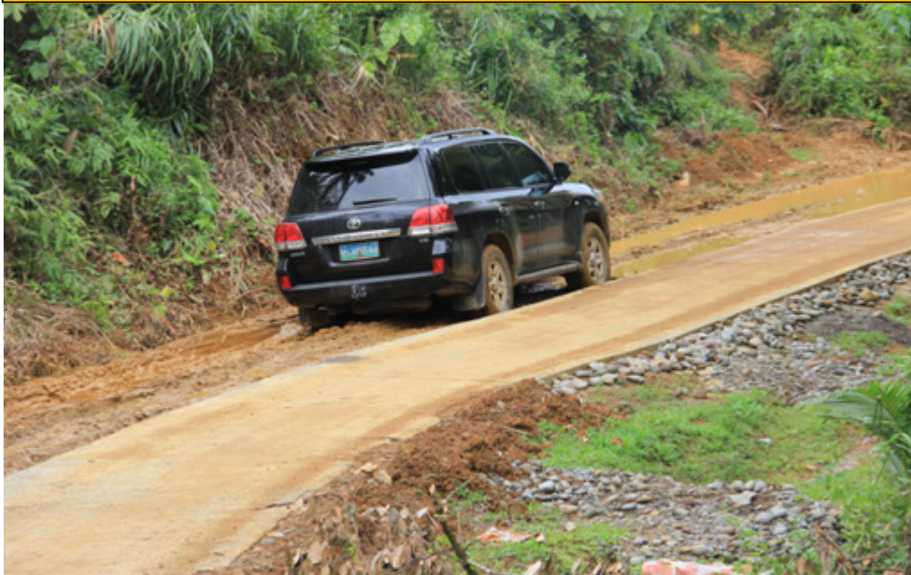
Concreting of San Martin, Jose Panganiban farm to market road-isa sa mga ARCP2 na proyektong kalsada sa lalawigan ibunga ng pagtutulungan ng pamahalaang panlalawigan at ng DAR. Binisita ito ng punong lalawigan sa kanyang pagtungo sa nasabing barangay na magsagawa ng multi-services caravan
